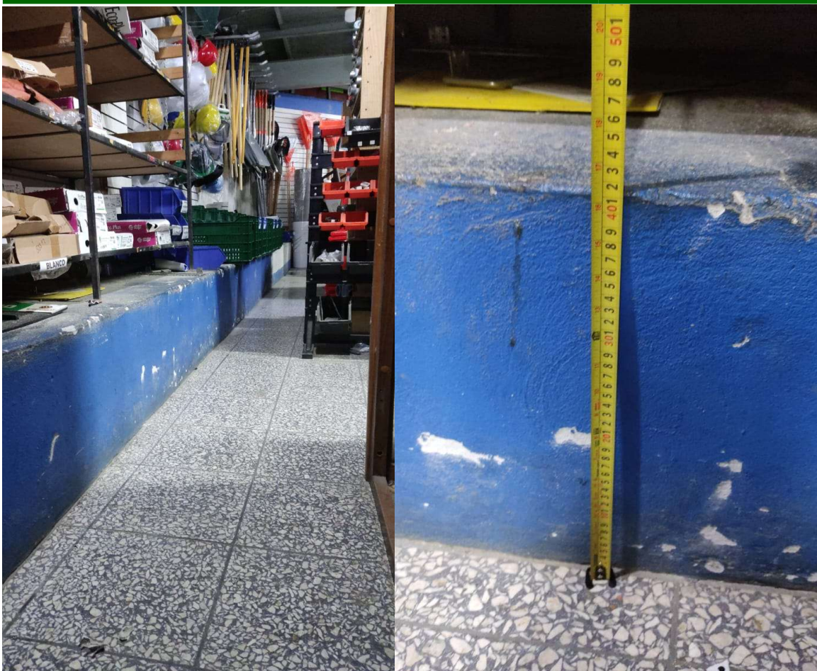
Imagen 12. Grada a demoler, es necesario demoler 30cm de profundidad para proveer pasillos aptos para tránsito según ley.
